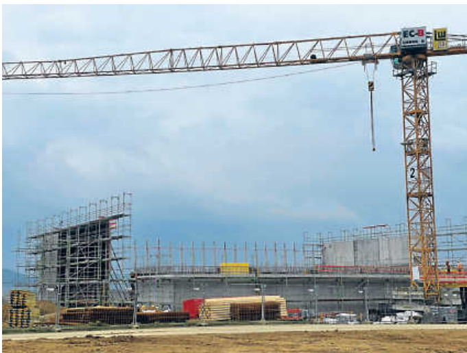
Die hohen Wände der neuen Doppelsporthalle an der Grundschule Limespark sind schon gut zu sehen
