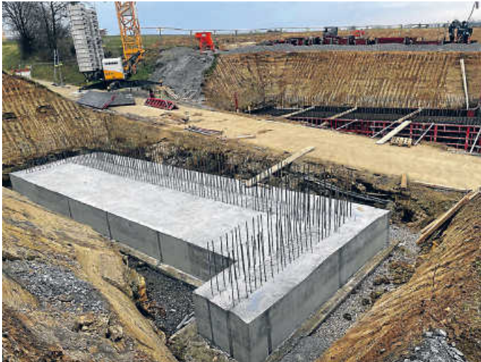
Die neue Brücke für die Verlängerung der Römerallee im Limespark über den Betonweg nimmt Gestalt an
